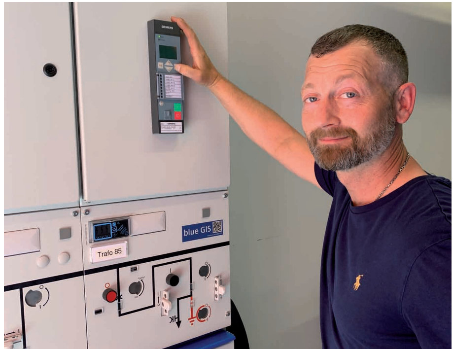
Andreas Grewe schaltet das Transformatorenschutzgerät ein.
